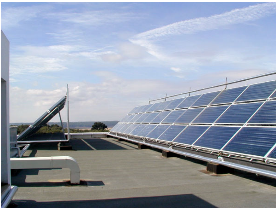
Figura 48 - Painéis solares térmicos [www.energiasrenovaveis.com]
