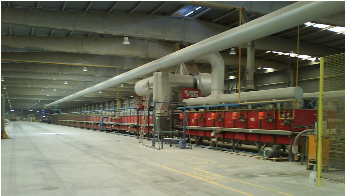
Figura 45 - Recuperação de ar quente num forno de rolos
