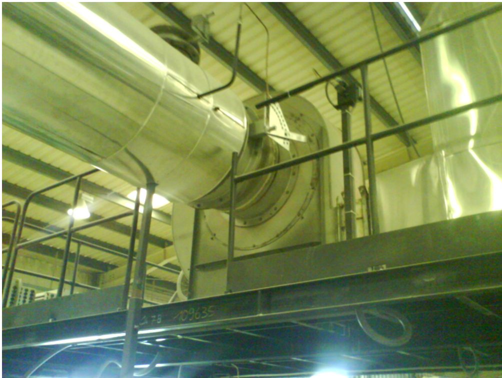
Figura 42 – Ventilador equipado com variador electrónico de velocidade
