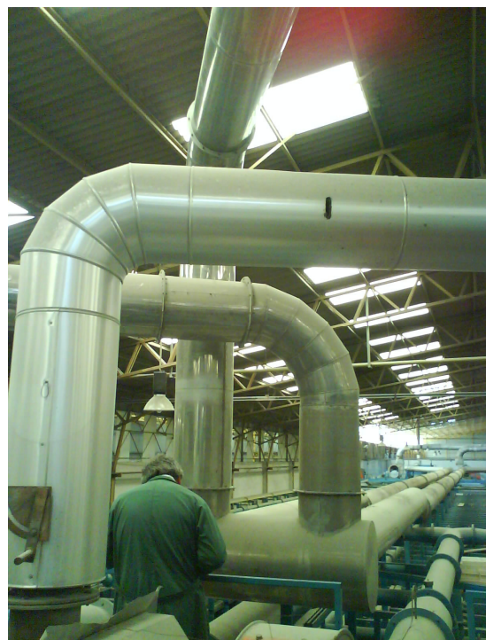
Figura 32 - Sistema de condutas de recuperação de ar quente de um forno
