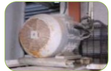
Figura 35 - Motor eléctrico em ambiente corrosivo
