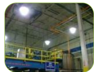
Figura 42 – Lâmpadas em nave industrial
