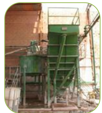
Figura 25 - Sedimentadores de lamelas
