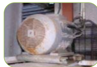
Figura 26 - Motor eléctrico em ambiente corrosivo
